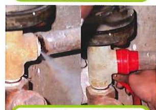
スチーム配管
